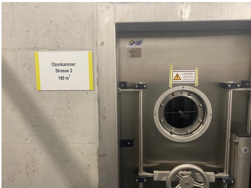
19. Die gesamte Verfahrenstechnik ist beschriftet worden, 14. Februar 2024
