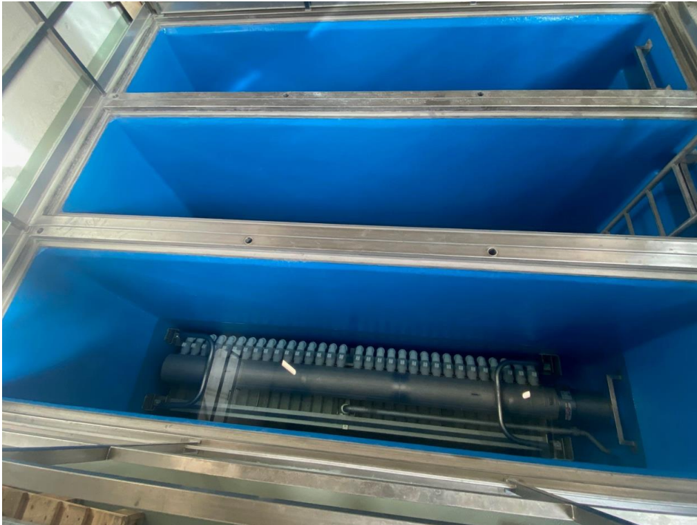
10. Sicht auf montierte Ultrafiltrations-Kassette (im Wasser), 14. Februar 2024
