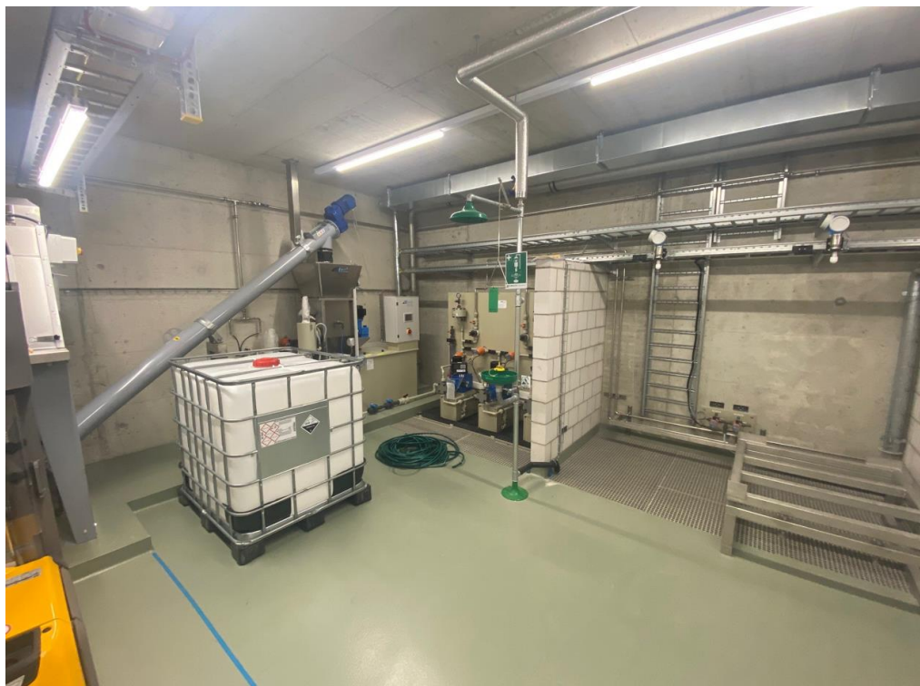
14. Montierte Chemie- und Augendusche in Bildmitte. Anmerkung: Diese kommt bei Chemieunfällen zum Einsatz. 14. Februar 2024
