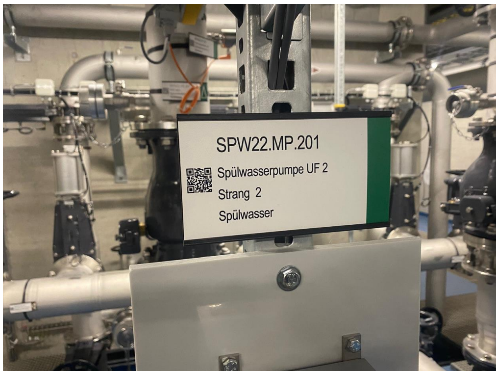
17. Die gesamte Verfahrenstechnik ist beschriftet worden, 14. Februar 2024
