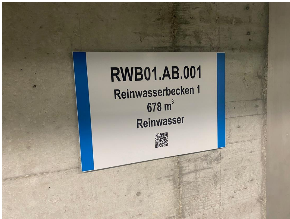
18. Die gesamte Verfahrenstechnik ist beschriftet worden, 14. Februar 2024
