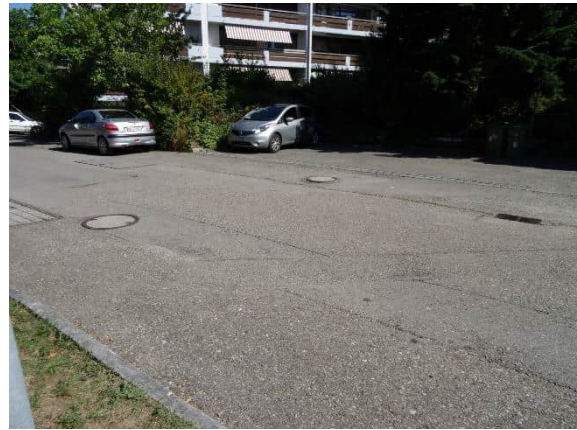
Diverse Belagsflicken durch Werkleitungsarbeiten
