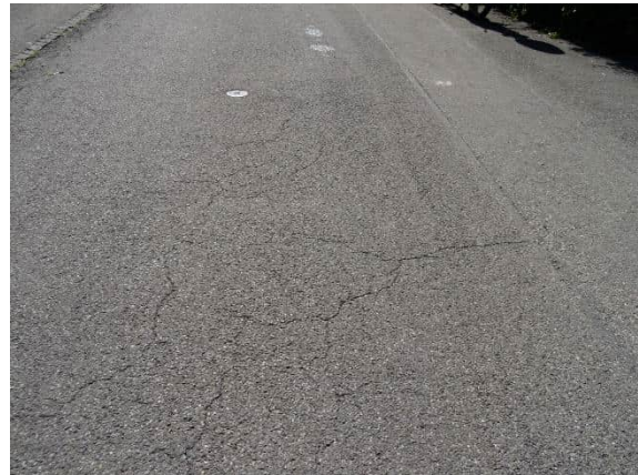
Abschnitt C : diverse Risse im Belag
