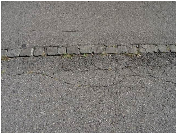
Abschnitt C : Schäden längs der Besteinung
