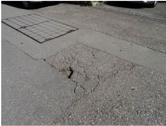
Abschnitt B : verschiedene Belagsschäden
