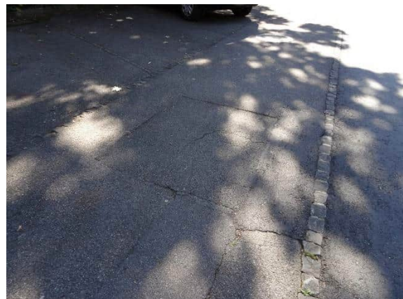
Abschnitt D : diverse Belagsflicken im Trottoir
