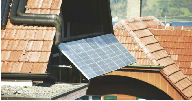
Solaranlage an Fassade
